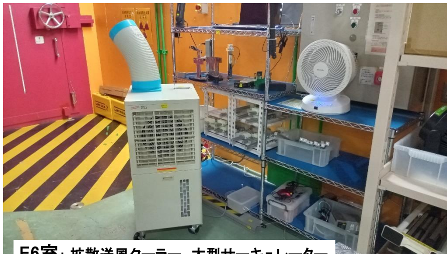
E6室: 拡散送風クーラー、大型サーキュレーター
